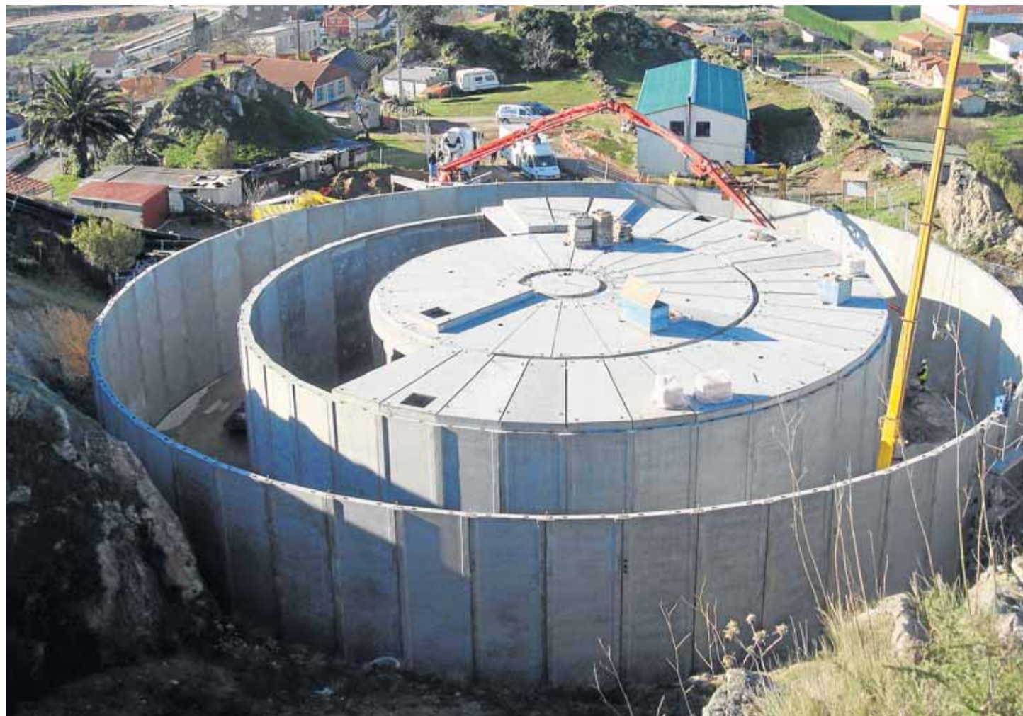
Abastecimiento a Santander. Depósito de agua de 9.000 metros cúbicos en Peñacastillo.
